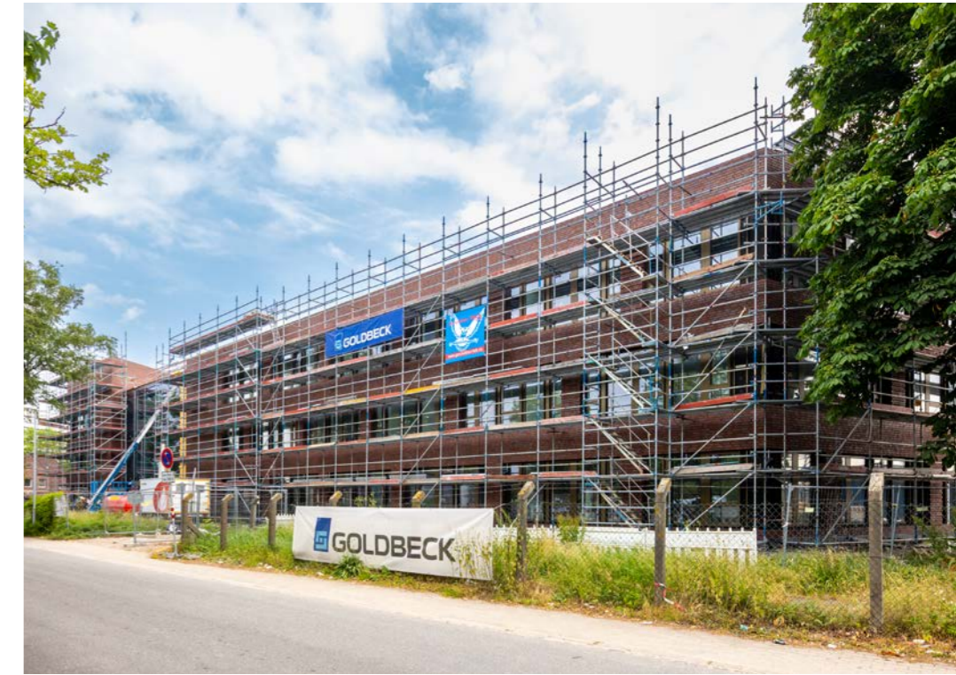
Bitte das Gerüst weg- und viel Grün hineindenken – die Außenanlagen des Amts werden kommunikationsfreundlich gestaltet. Die Gebäudekubatur ermöglicht zugleich eine natürliche Verschattung.
